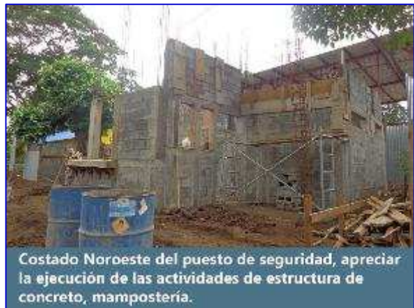
Panorámica del Puesto de Seguridad, observar la ejecución de las actividades de mampostería, estructura de concreto.
